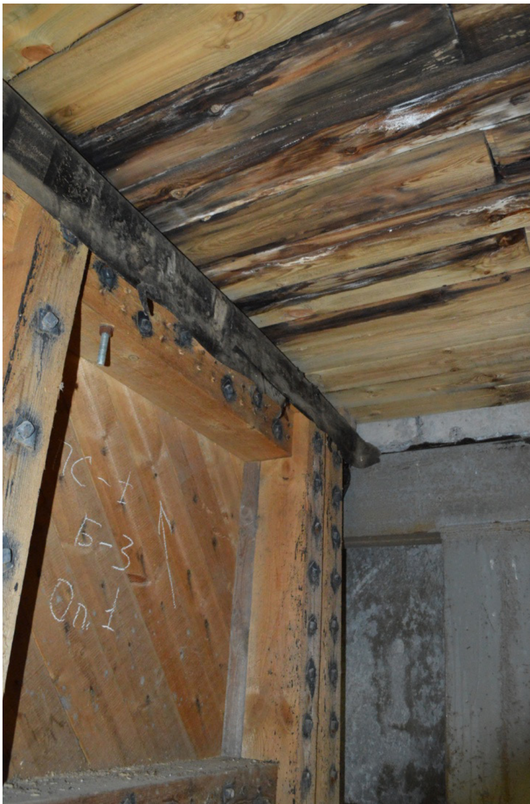
Рисунок 10 – Следы протечек воды и мест гниения поперечного настила у шкафной стенки Источник: составлено авторами.
