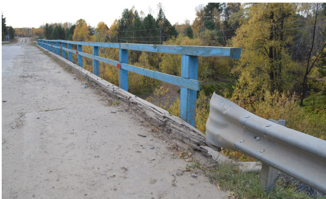
Рисунок 13 – Разрушение колесоотбойного бруса, пораженного гнилью Источник: составлено авторами.
