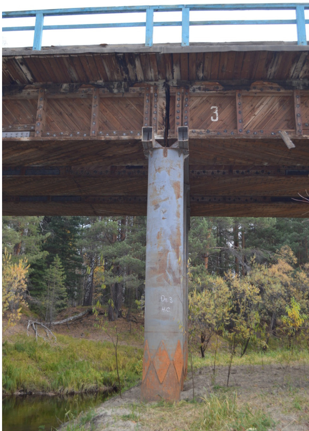
Рисунок 11 – Следы протечек воды и мест гниения поперечного настила над промежуточной опорой Источник: составлено авторами.
