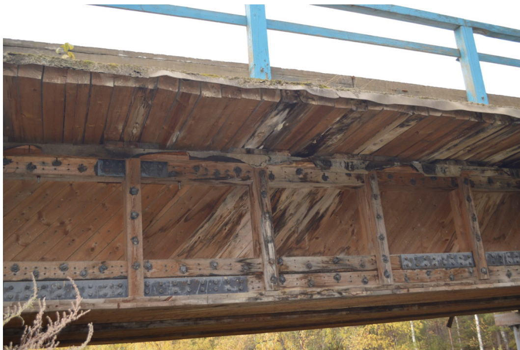
Рисунок 12 – Следы протечек воды и мест гниения стенки из перекрестных досок Источник: составлено авторами.
