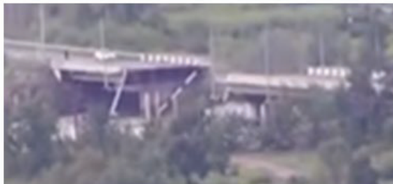
Рисунок 5 – Этапы обрушения автомобильного моста в г. Чите
