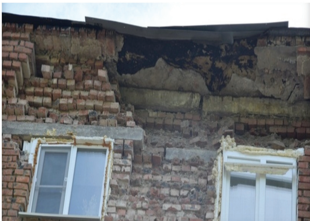
Рисунок 2 – Обрушение наружной стены жилого здания
