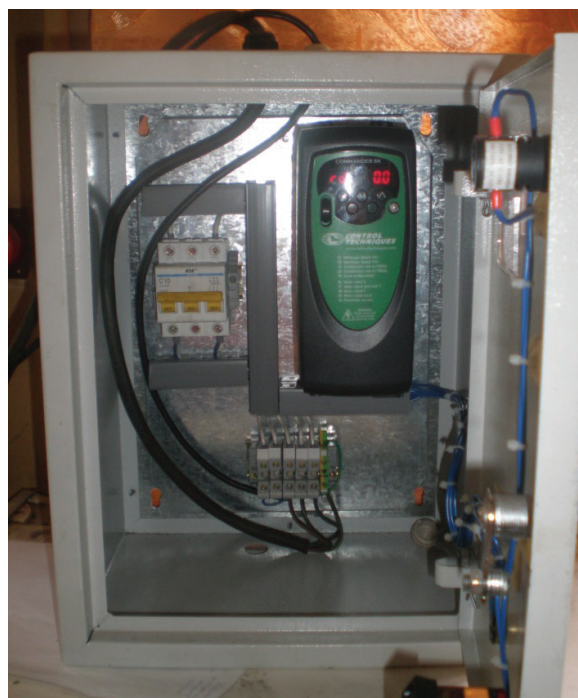
Рисунок 1 – Блок управления опытной виброплощадки
