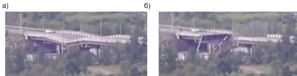
Рисунок 5 – Этапы обрушения автодорожного моста в г. Чите
