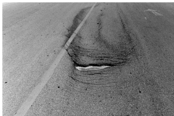
Рис. 2. Поверхностная колея на покрытии, сопровождаемая просадкой асфальтобетона
