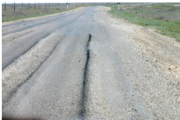
Рис. 1. Поверхностная колея на покрытии, сопровождаемая выпором асфальтобетона
