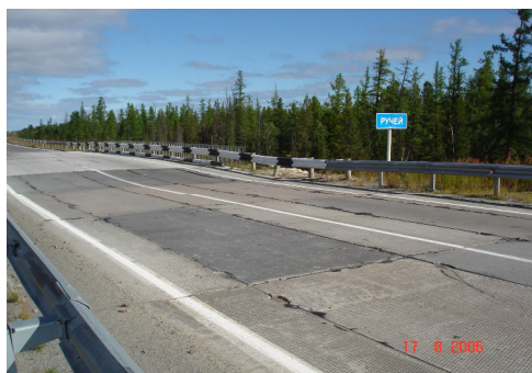
Рис. 1. Деформации насыпи на сопряжении с мостом
