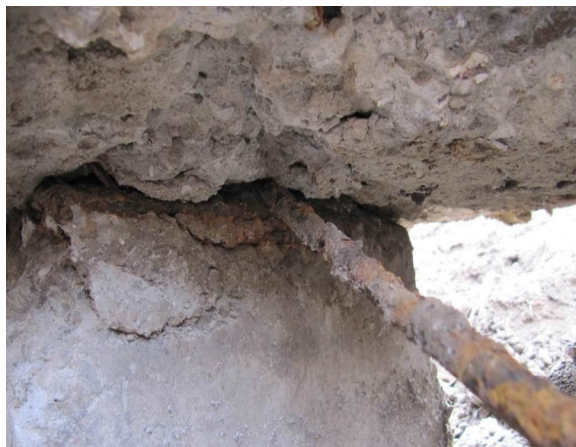
Рис. 2. Зазоры между сваями и ростверком в результате пучения
