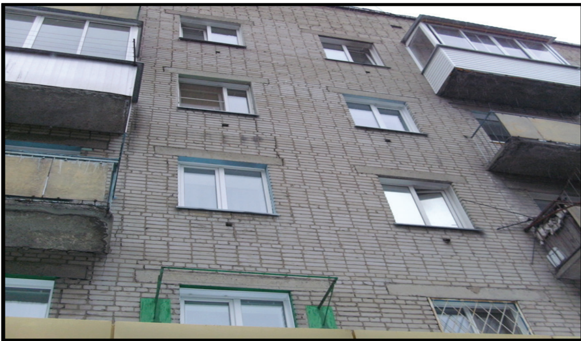
Рисунок 4 – Вертикальные трещины шириной раскрытия до 7 мм в наружной стене. Локальные участки замачивания балконных плит
